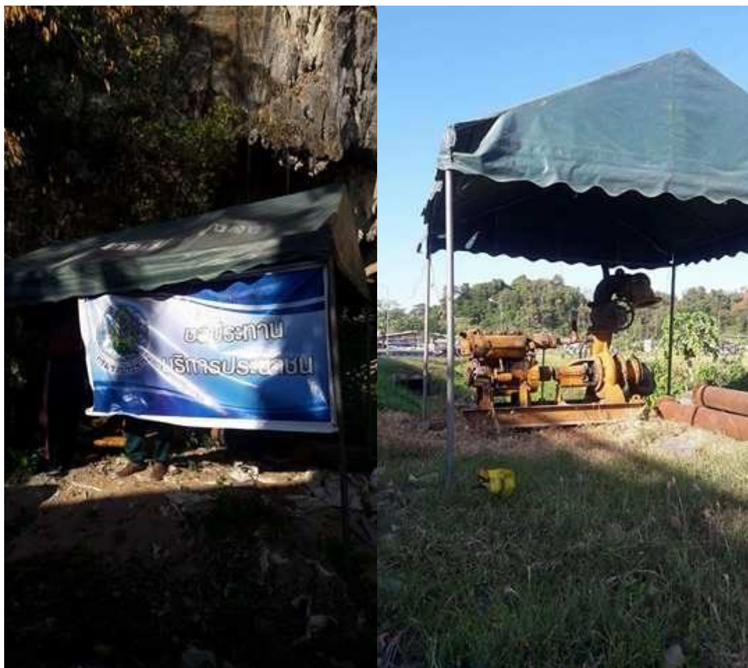
เครื่องสูบน้ำ จำนวน ๒ เครื่อง ที่เทศบาลเมืองทุ่งสงได้ทำโครงการขอสนับสนุนเครื่องสูบน้ำ จากโครงการชลประทานนครศรีธรรมราช ซึ่งเจ้าหน้าที่เทศบาลเมืองทุ่งสง และเจ้าหน้าที่ ชลประทานนครศรีธรรมราชได้นำมาติดตั้งไว้ ณ บริเวณหลังถ้ำตลอดและบริเวณศาลาที่พัก ผู้โดยสารเชิงสะพานลอยถนนทุ่งสง-ห้วยยอด
